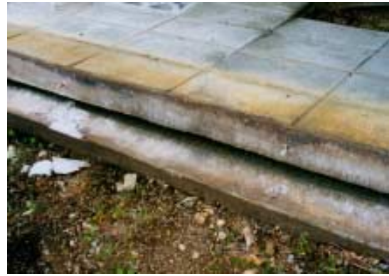
写真18 脚部から転倒したブロック塀(日野町下榎)
