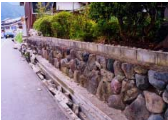
写真17 中間部から転倒したブロック塀(日野町下榎)
