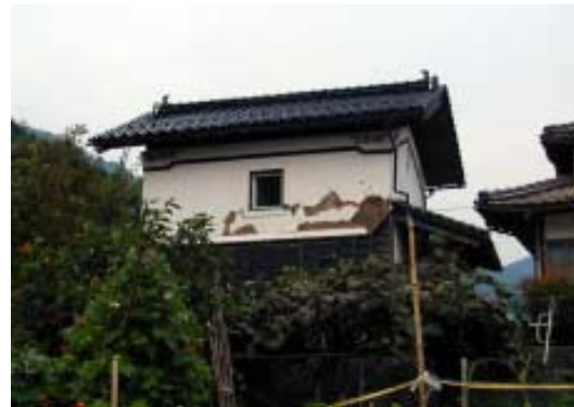
写真6 土蔵の被害(日野町下榎)
