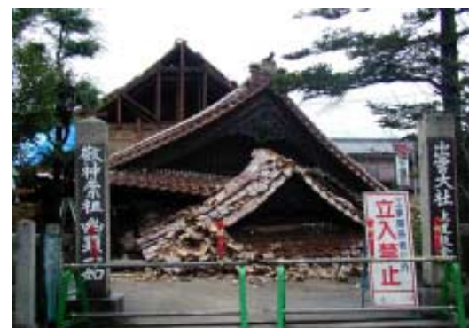
写真7 神社建築の倒壊(境港市)
