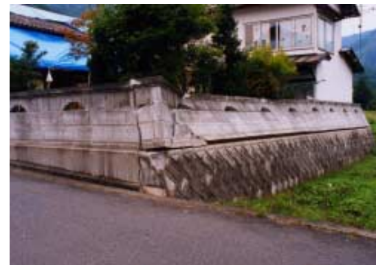
写真19 大きく傾斜したブロック塀(日野町下榎)
