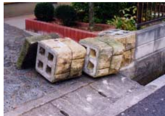
写真21 転倒した組積造の門柱(日野町黒坂)
