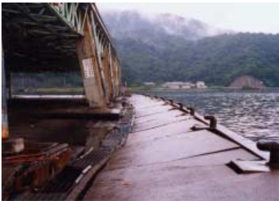
写真23 地盤変状により傾斜したSRC造柱(境港市)
