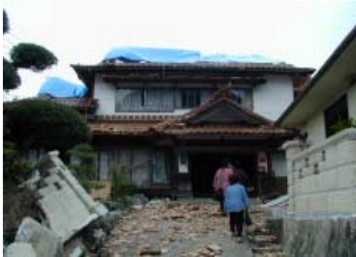
写真4 1階が大きく傾斜した木造住宅(日野町下榎)
