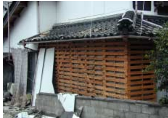
写真3 住宅のラスモルタルの崩落(日野町下榎)
