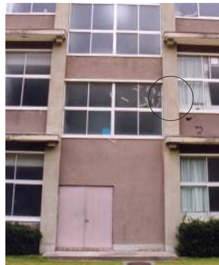
写真10 3階建日南中学校校舎2階柱の右下がりのせん断ひび割れ(日野郡日南町)
