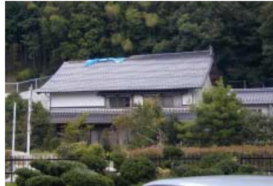
写真2 木造住宅の棟瓦の滑落(日野町根雨)
