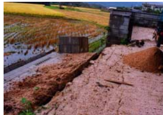
写真20 ブロック塀とブロック造擁壁の転倒(西伯町倭)
