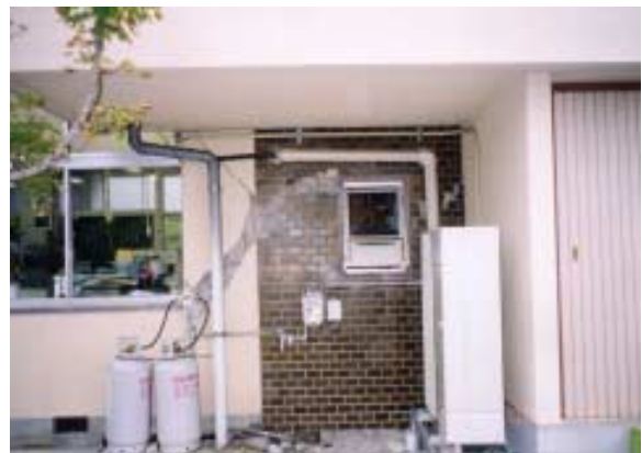
写真13 1階壁とその側柱のせん断破壊(会見小学校)
