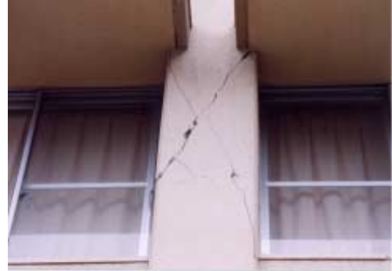
写真9 4階建病院棟の1階柱のせん断ひび割れ(境港市)
