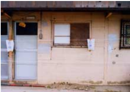
写真16 ひび割れが生じたブロック造帳壁（日野町野田）
