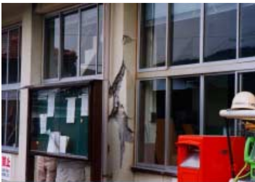
写真8 2階建溝口町役場の1階柱のせん断破壊
